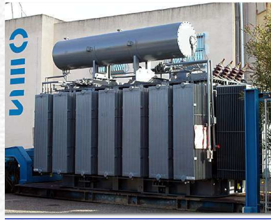
Trasformatore da 2500 KVA
